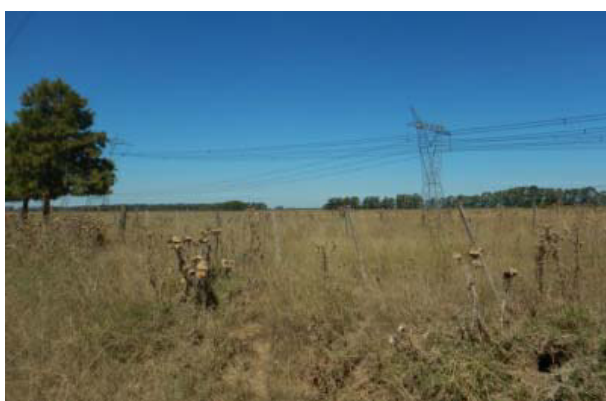
Torres de la LEAT Rodríguez-Ezeiza en el punto del inicio del By Pass.
