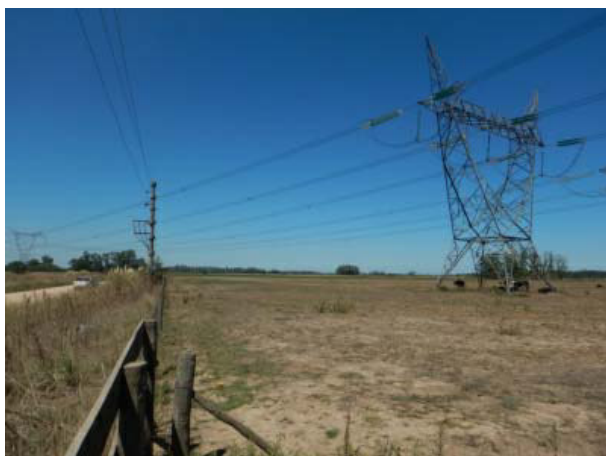
Torres de la LEAT Rodríguez-Ezeiza en el punto del inicio del By Pass.
