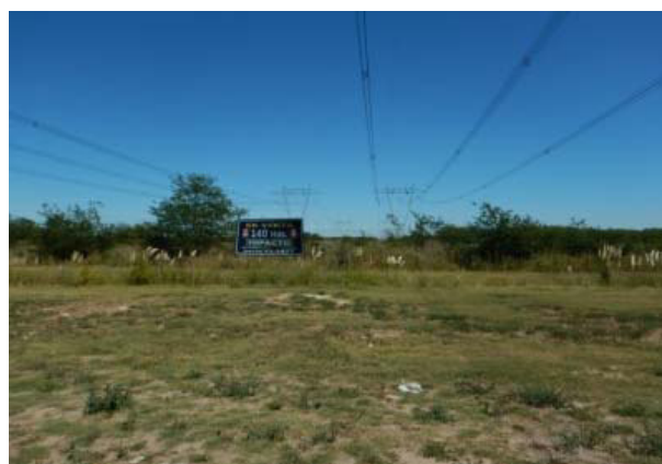
Torres de la LEAT Henderson - Ezeiza en el punto de finalización del By Pass.
